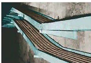
Protección de bandejas de cables.
