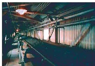
Protección de cintas transportadoras.
